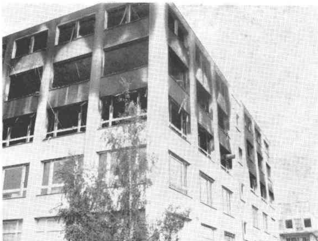
Das Gebäude nach überstandem Brand
