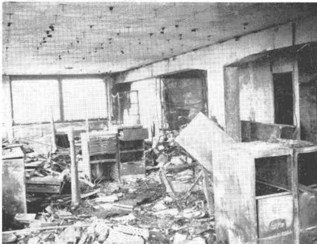
Blick in den verwüsteten Büroraum im fünften Geschoss
